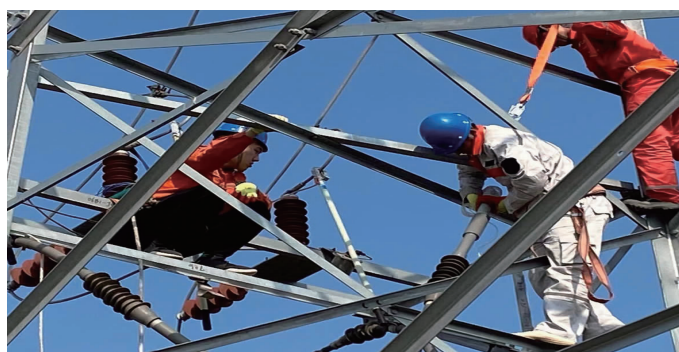
10月25日,供电公司工程营销部配备优质精干队伍,前往灌云和风电工程进行维保,扎实做好电力供应配套服务,继续以“短、平、快”工程项目建设和100%热心服务保障企业用上安全电、及时电、放心电。(郑皓)
